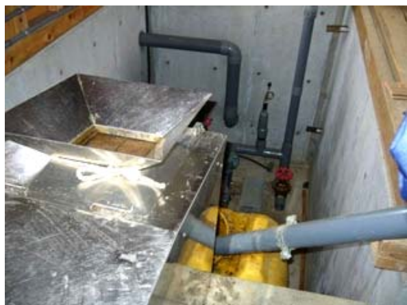
バイオガスプラントの装置の一部分
