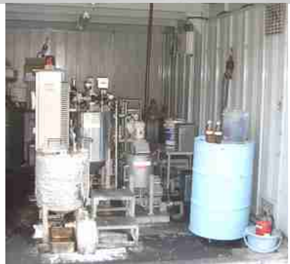
ちちぶバイオマス てんぷら油リサイクル工場
